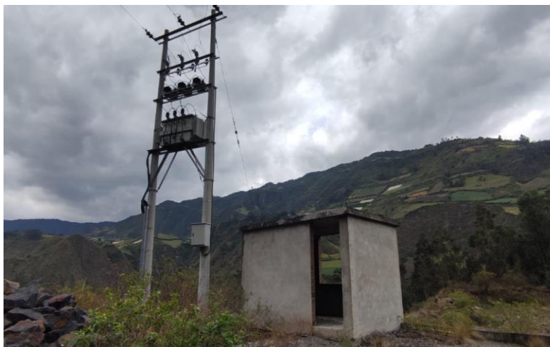
Fig. 5. Cabina de control trituración, en estado de abandono
