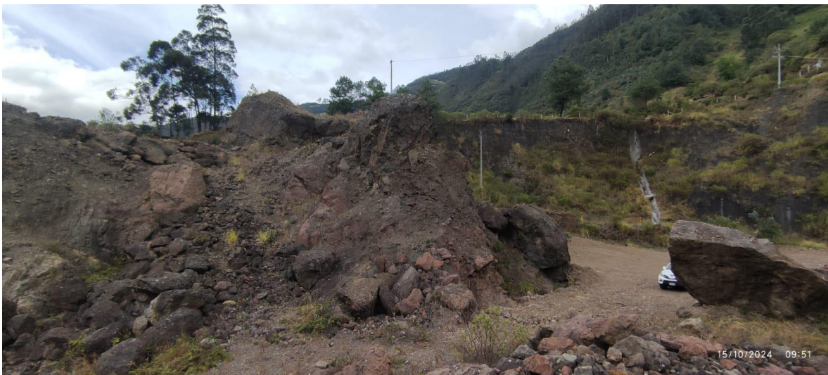
Talud irregular en estado inactivo.
