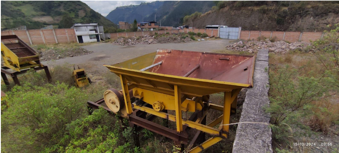
Montaje trituración, sin actividad minera.
